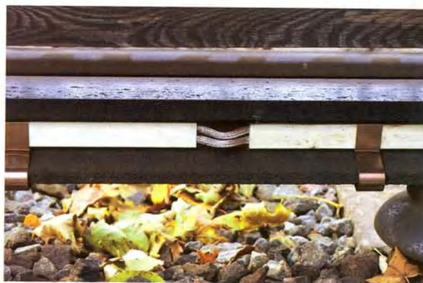
Värmekabeln hålls fast längs strömskenan med metallklamrar.
